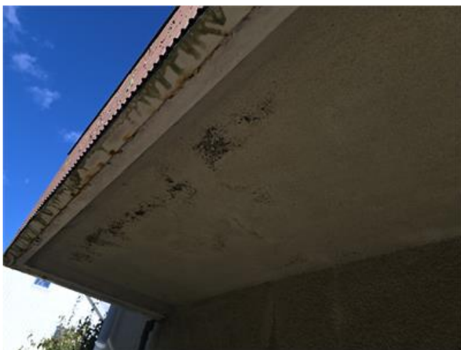
Exempel på balkong och färgsläpp och rostangrepp.
