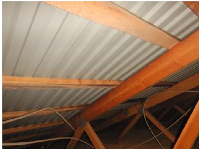
Inget kondensskydd under plåttak över garage
