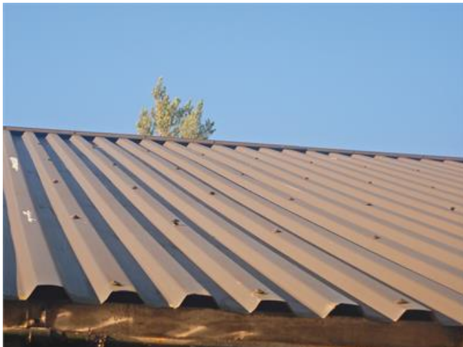
Lösa spikar i plåttaket
