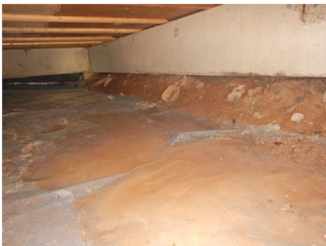
Vatten på plastfolien i krypgrunden
