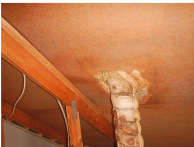
Missfärgningar omkring genomföringar på vinden
