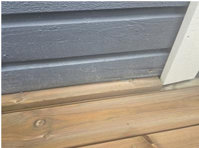
Exempelbild, rötskadad fasad.
