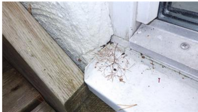
Fönster med torrsprickor samt otät infästning av fönsterbleck
