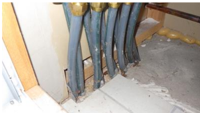
Ej våtsäkrat runt värmerör
