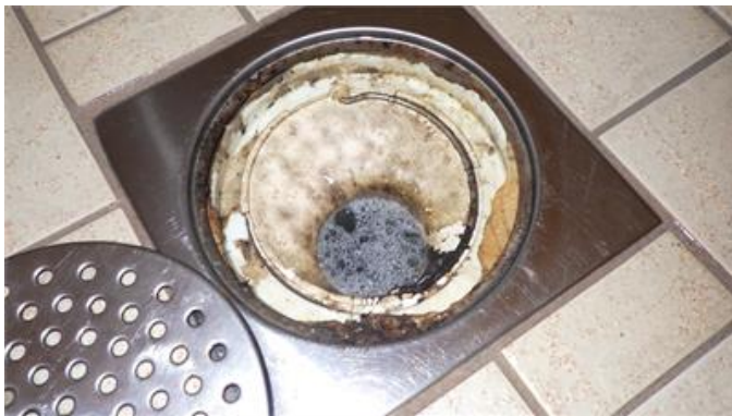
Golvbrunn utan synlig brunnsmanschett eller klämring
