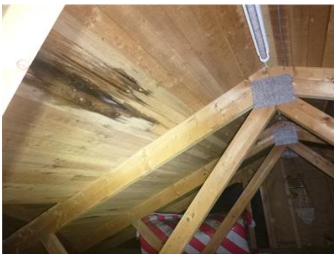
Bilden visar exempel på missfärgning/inläckage på vinden.
