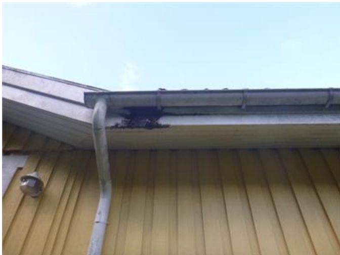
Bilden visar rötskador/läckage i takutsprånget.
