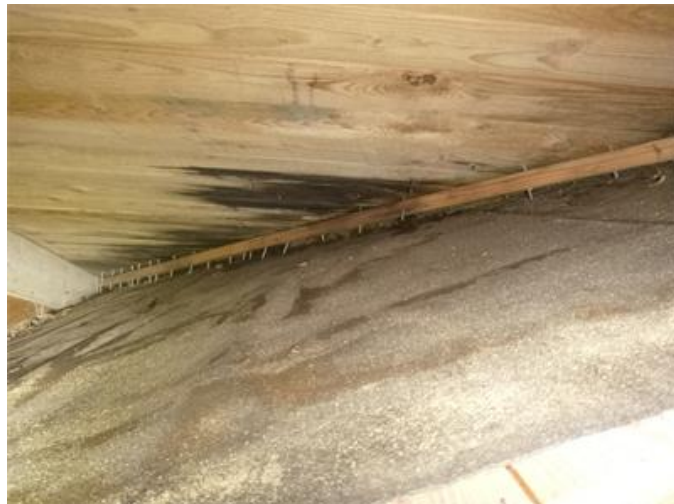
Bilden visar exempel på missfärgning/inläckage på vinden.
