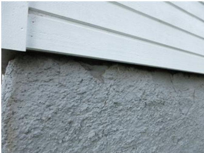
Exempel på sprickor/putssläpp i sockel/grundmur
