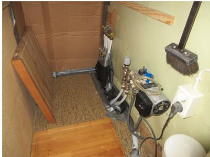
Inget fuktskydd på golv i kattvind under vatteninstallationer
