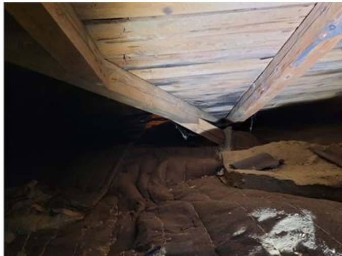
Mikrobiell påväxt på underlagstak.
