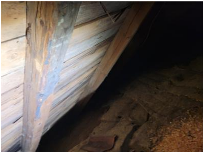
Mikrobiell påväxt på underlagstak.
