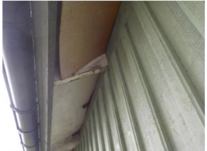
Garaget: Vindavledare som har lossnat.
