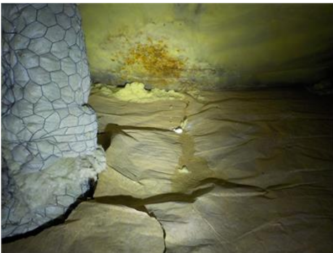
Sidovind nordväst: Spår efter möss i isoleringen.
