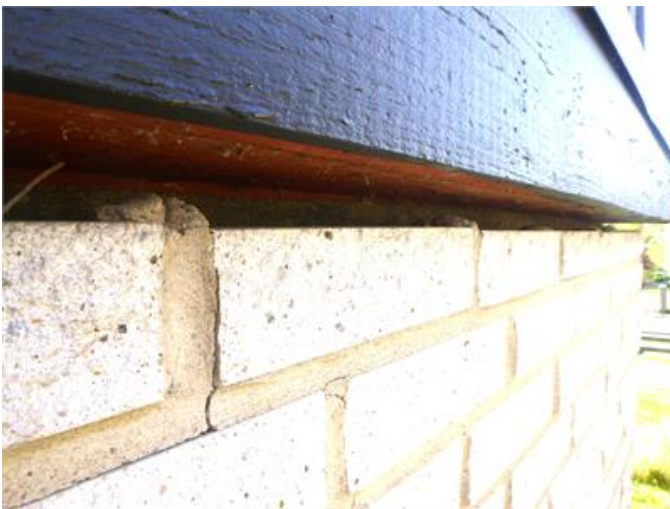
Bristfälligt väderskyddat mellan fasad och balkongen
