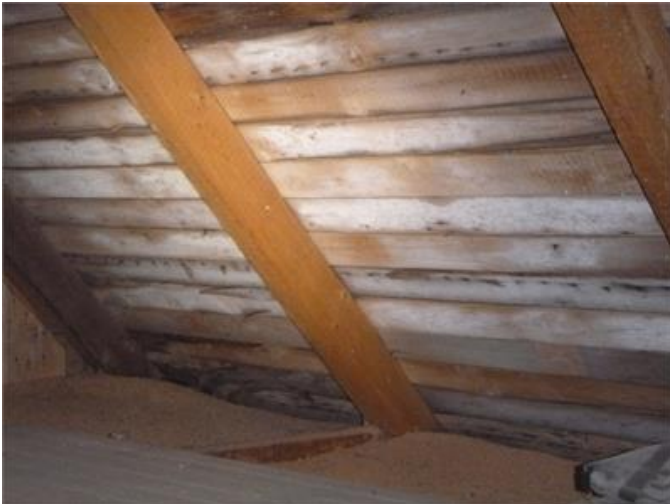
Mikrobiell påväxt på insida yttertak
