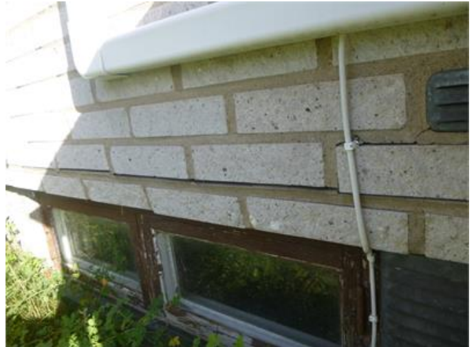
Nedhängda stenar ovan källarfönster mot framsidan
