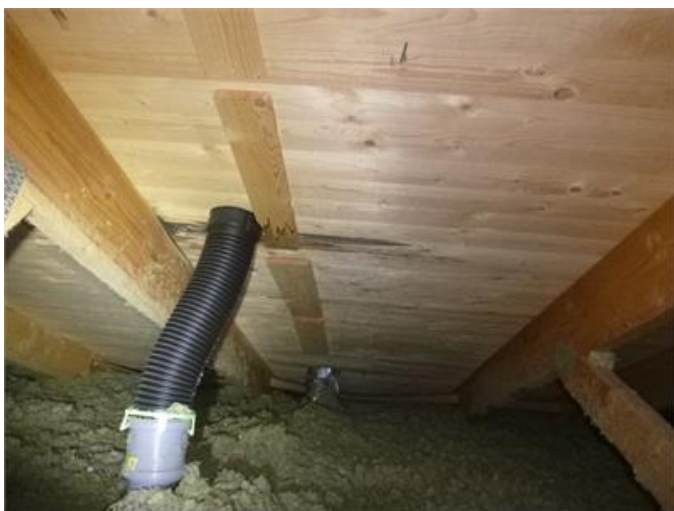
Bilden visar exempel på missfärgning i yttertaket.
