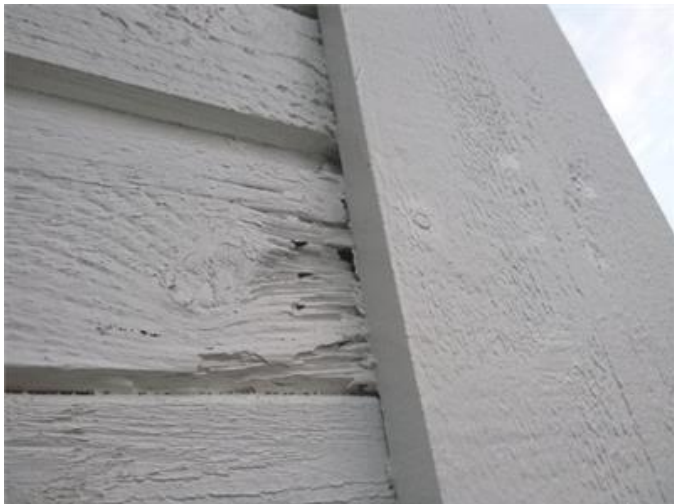
Bilden visar rötskada i fasaden.
