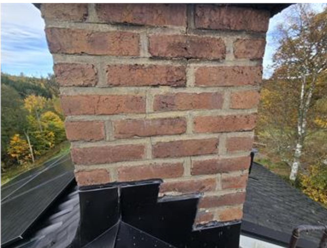
Tak: Murstock har mindre sprickor i fogar samt mossor, väderskydd finns ej.
