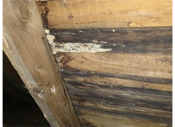
Nockvind: Missfärgningar samt mikrobiell påväxt lokalt mot söder, sannolikt sedan innan takrenovering.
