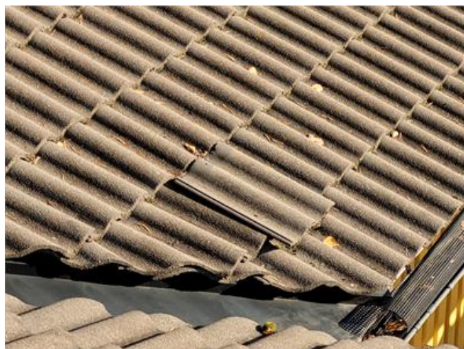
En takpanna är felmonterad
