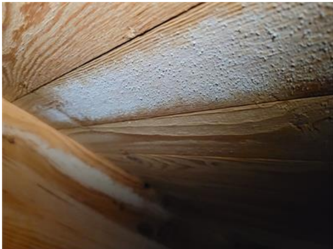
Mikrobiell påväxt förekommer på underlagstak
