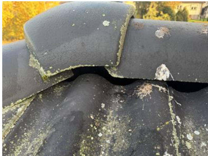
Nocktätning finns ej och takpannor som ej är spikade.
