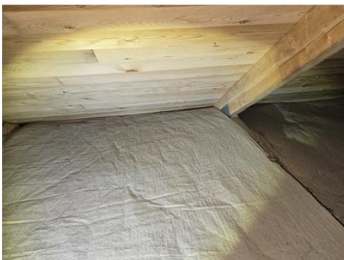
Nockvind: Isolering ligger delvis an mot underlagstak.
