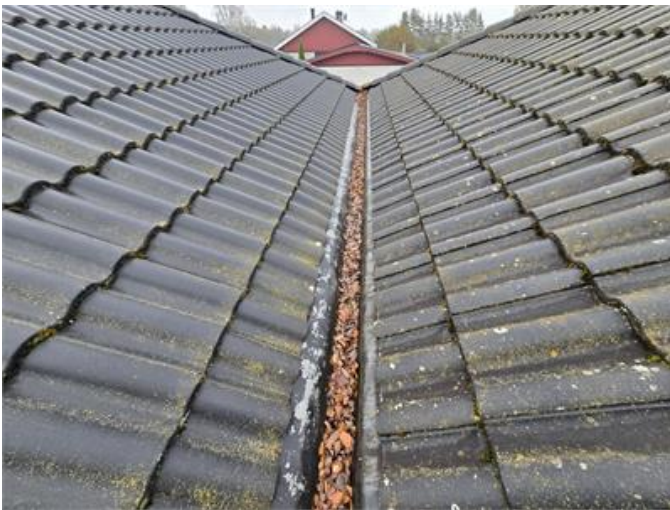
Tak: Tak är uppört som motfallstak. Rännor fyllda med skräp.
