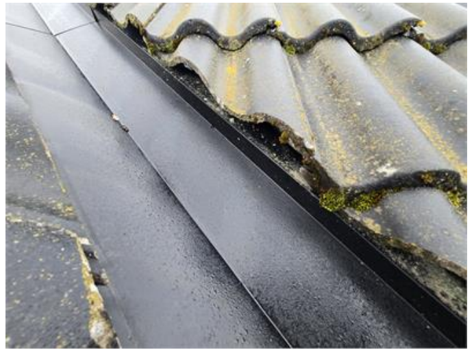
Tak: Pannor i rännkal skurna nära kanten, risk för inträngande vatten.
