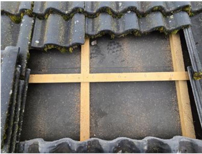
Tak: Stickprovskontroll under pannor, frömjöl noteras.
