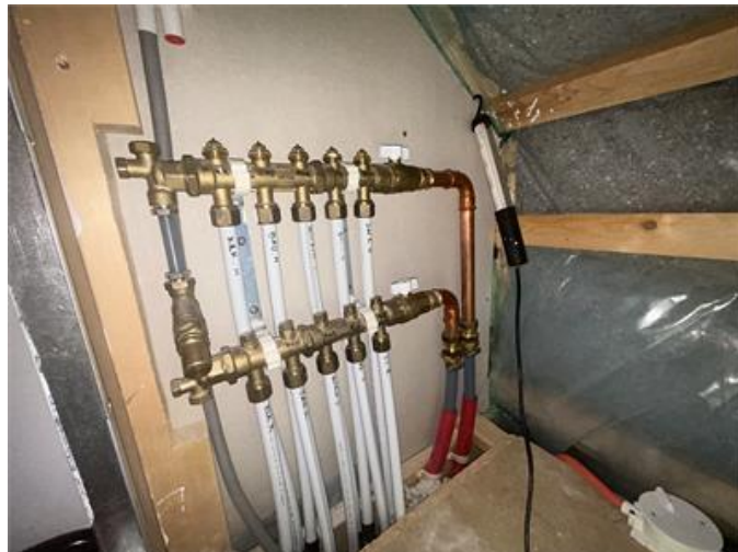
Sidovind sydväst: Fördelare utan fördelarskåp finns i den sydvästra sidovinden.
