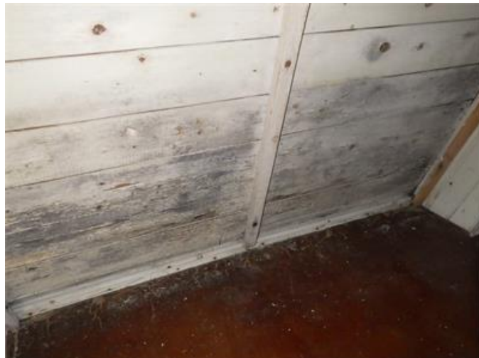
Mikrobiell påväxt på underlagstak i sidovind.
