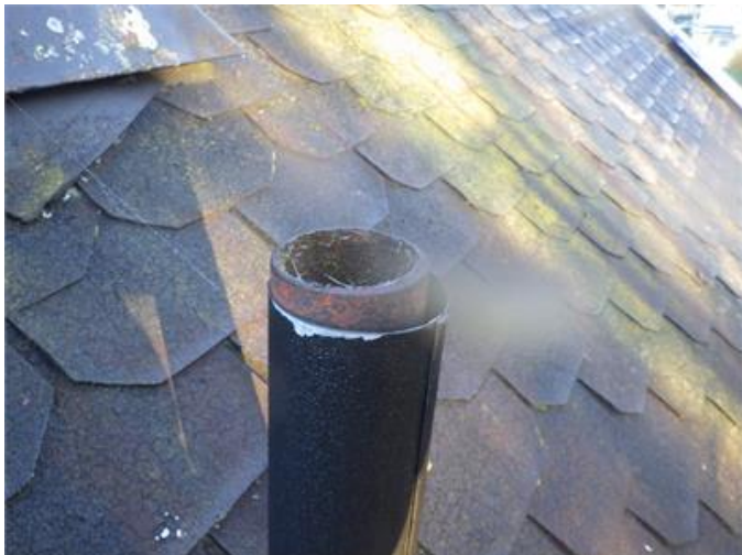
Otät plåtanslutning mot avloppsluftare.
