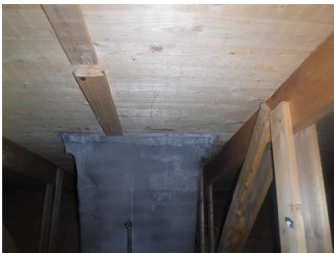
Vind/bostadshuset: Mindre lokala spår av fuktrinrängningar runt skorsten och rörgenomföring.
