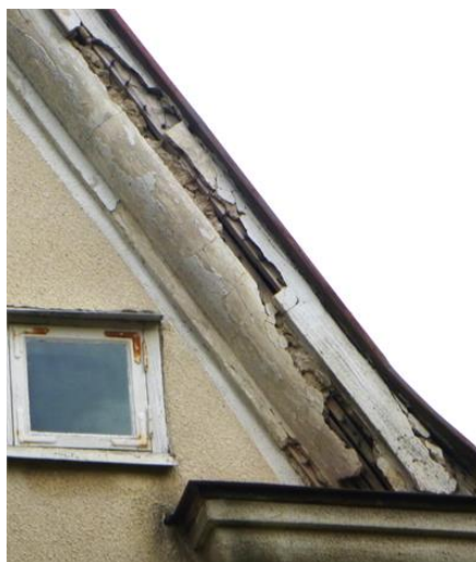
Skador i den putsade fasaden
