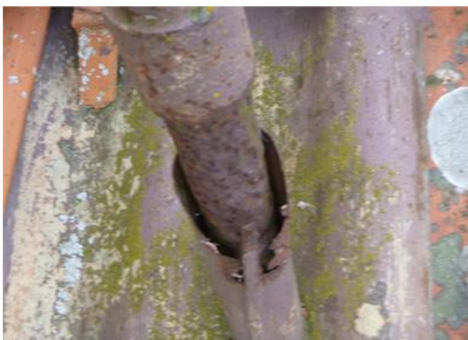
Otät plåtning kring expansionskärlets genomföring i yttertak
