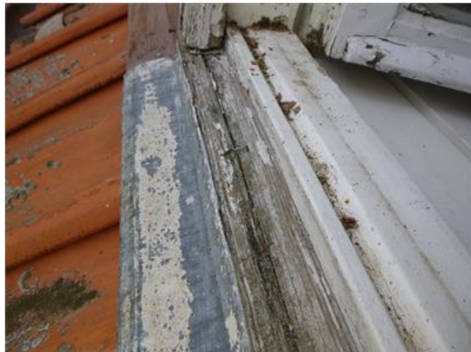
Skador i fönsterkarm
