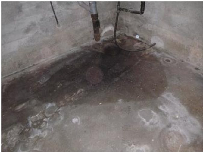
Spår av vatten som trycker upp kring avlopp i källare
