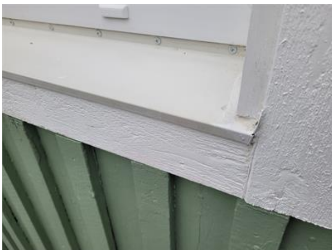
Fönsterbleck saknar utstick från fasad
