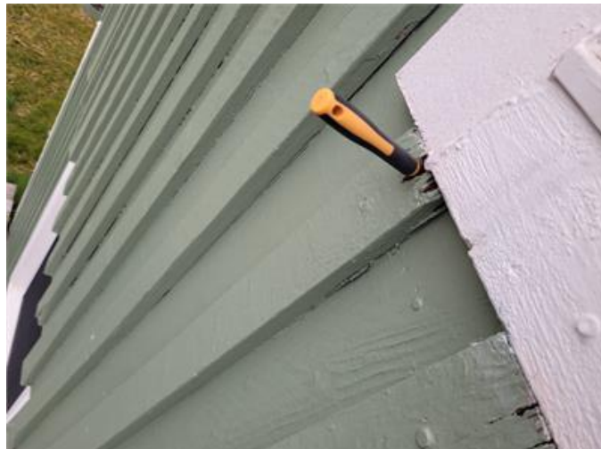
Rötskador i fasadpanel.
