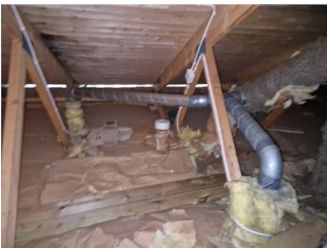
Vind, missfärgningar noteras på underlagstak. Oisolerade ventilationskanaler med risk för kondensbildning förekommer.
