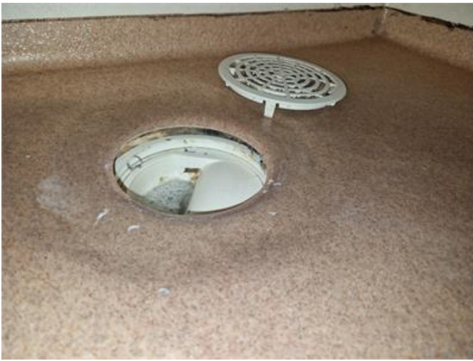
Plastmattor ansluter ej mot golvbrunnar.
