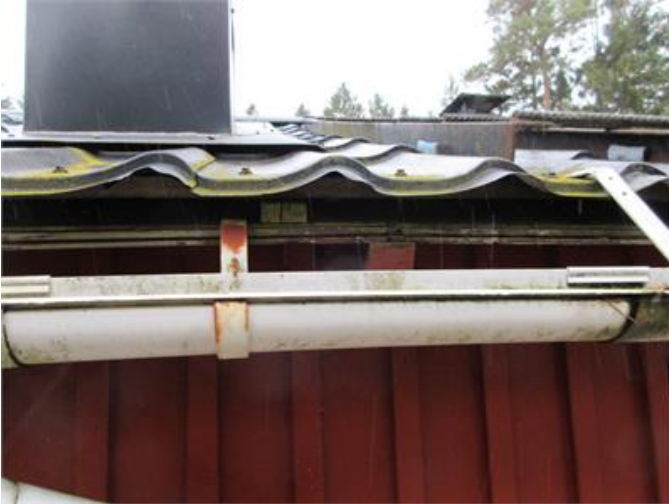
Taket är fuktpåverkat pga av att fotplåtar saknas
