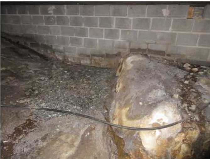
Fuktgenomslag på grundmurar samt mikrobill påväxt på mark
