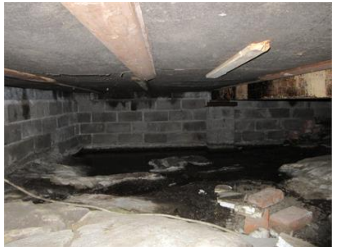
Fuktgenomslag på grundmurar samt vattenansamlingar på mark
