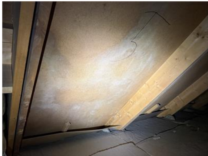
Exempel på spår av läckage i underlagstak
