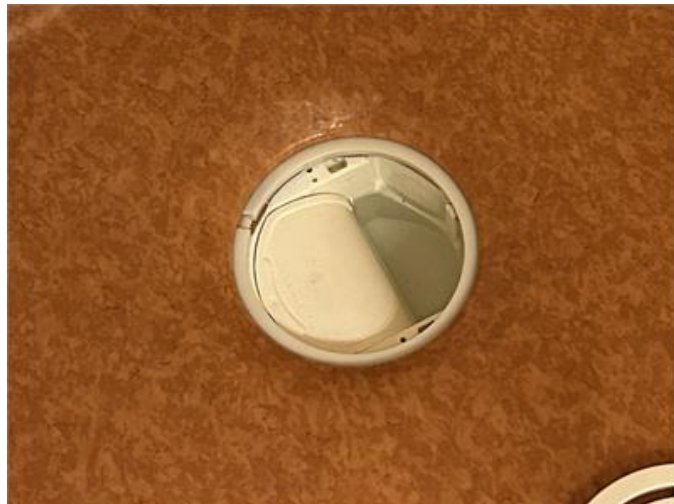
Synlig plastmatta i golvbrunn.
