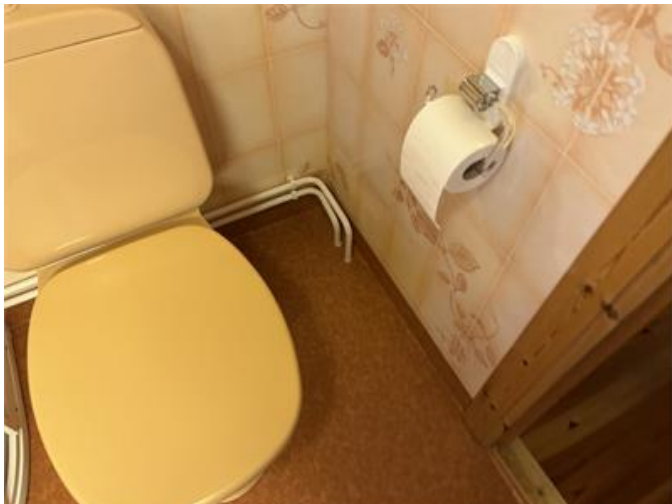
Rör genomföring i golv.
