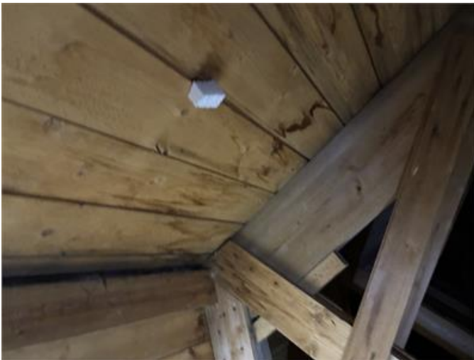
Sidovind: Missfärgningar finns på underlagstaket, torrt vid besiktningstillfället.
