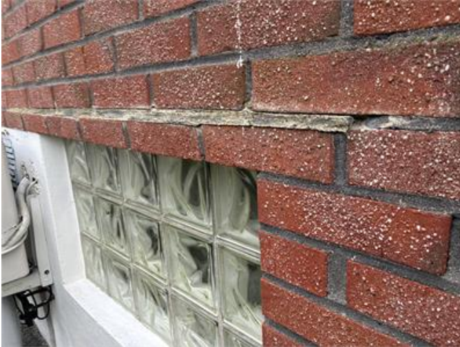
Fasad: Tegelfog släpper på några ställen
