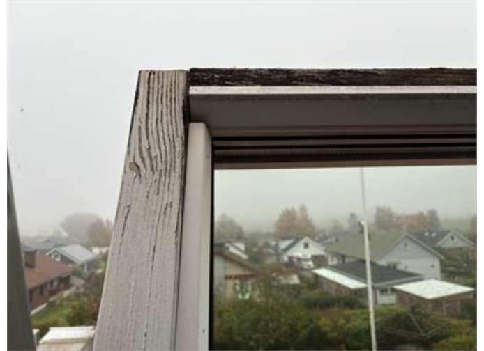
Fönster: Fönster i takkupa på övre plan har bristfälligt underhåll och kan behöva bytas.
