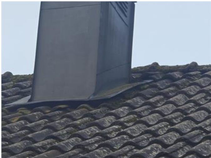
Exempelbild, otätheter mellan plåtarbeten/takpannor, yttertak.
