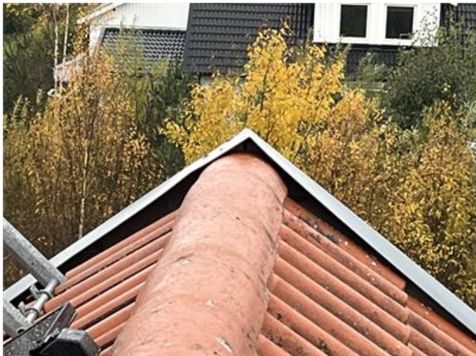
Något bristfällig täckning mellan takpannor och vindskeveplåt
