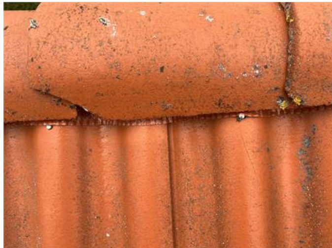
Spikhål på övre rad takpannor som ej täcks helt.
