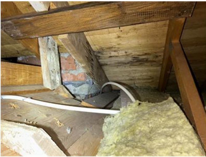
Nockvind väster: Fuktanvisningar runt murstocken. Torrvind besiktning.
