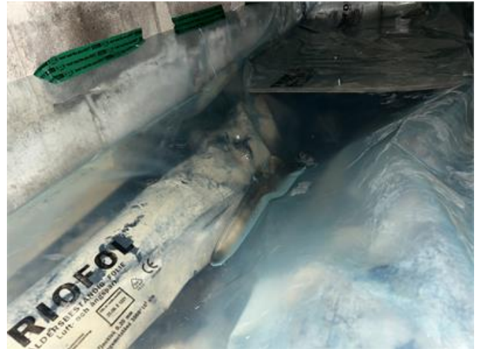
Krypgrund öster: Fritt vatten noteras på plasten.
