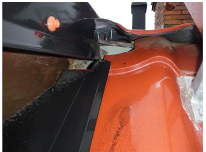
Något otätt i plåttakets brytning kring baksida takkupa
