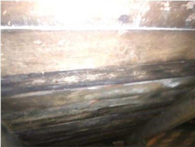
Mikrobiell påväxt insida yttertak
