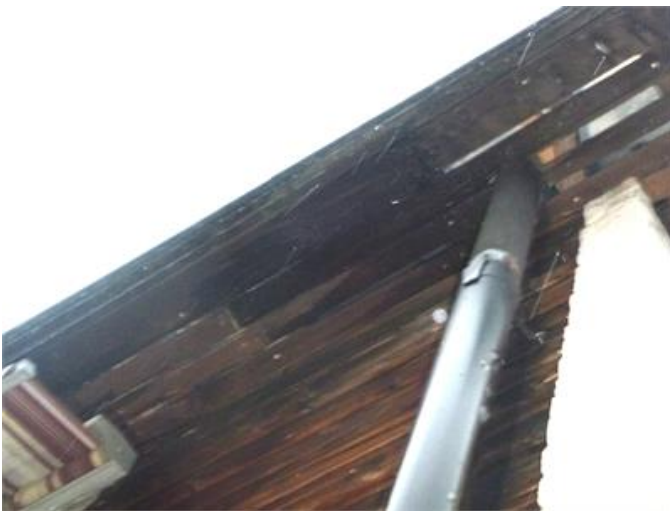
Genomsläckage i takfotens inklädnad baksida låglutande tak
