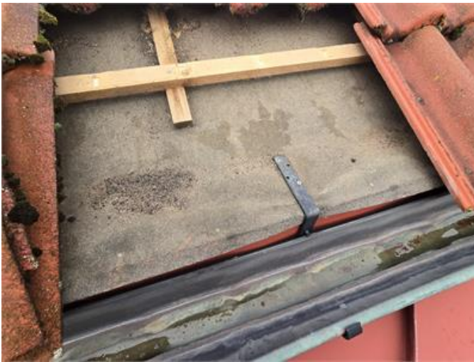
Tak: Stickprovskontroll under pannor, krok skruvad genom papp, takfotsplåt finns ej.
