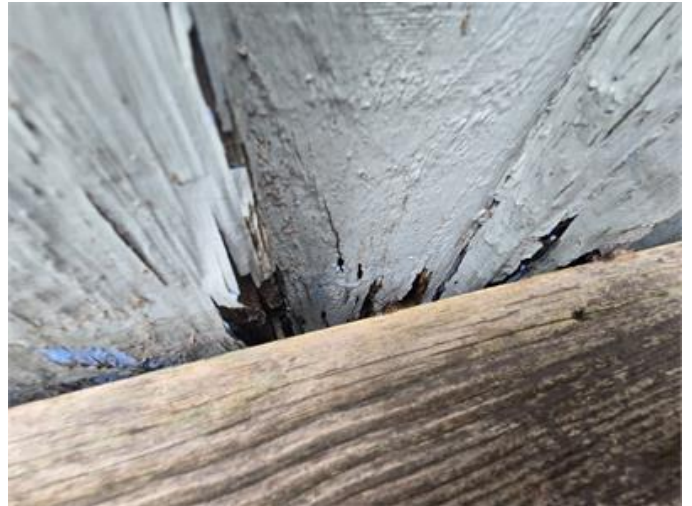
Fasad: Rötskador i fasad.
