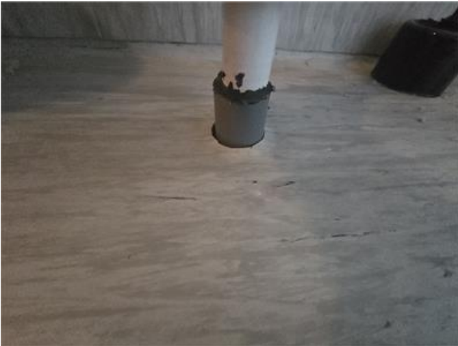
Dusch/Wc: Otätheter runt avloppsrör.
