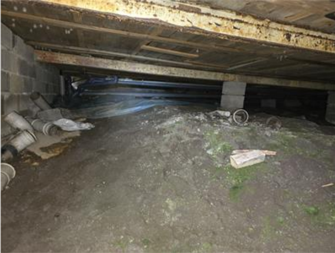
Krypgrund: Översiktsbild mot norr, fuktig miljö samt byggspill i utrymmet.
