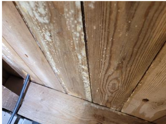
Mikrobiell påväxt på golvbjälklagets undersida.
