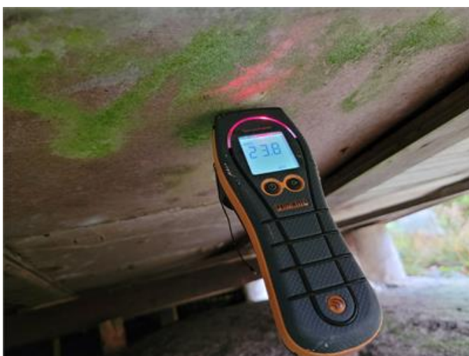
Mikrobiell påväxt samt mosspåväxt på golvbjälklagets undersida (Gästhuss)
