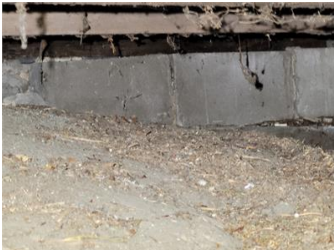
Missfärgning på syll sett från krypprunden
