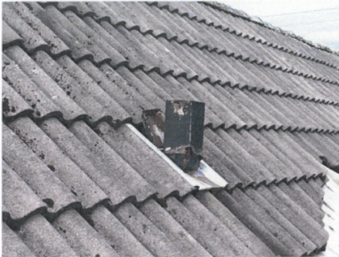
Plåthuv rostig på taket.
