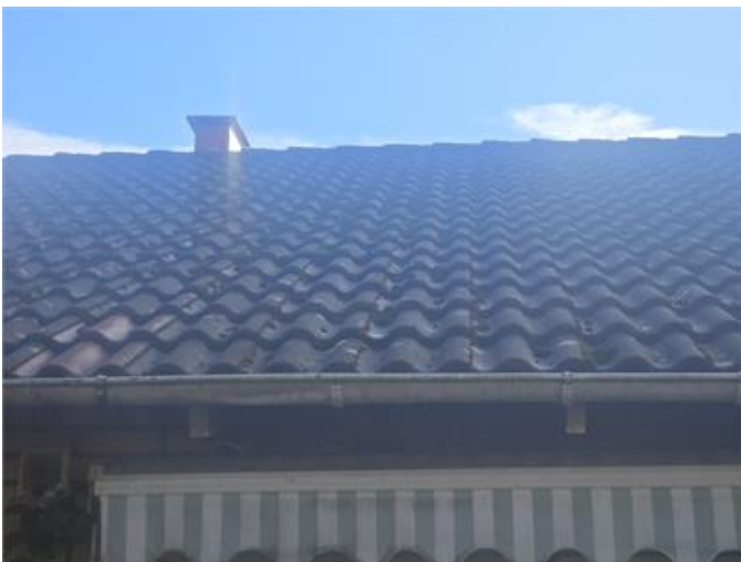
Översiktsbild, yttertak med mosspåväxt på takpannor.
