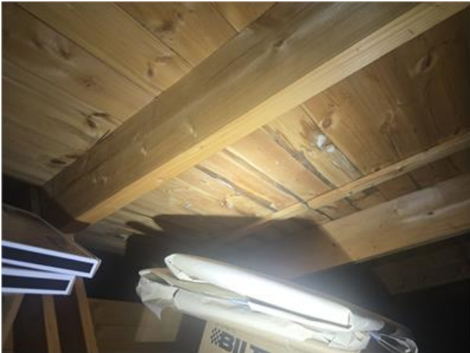
Exempelbild, fuktfläckar underlagstak, sidovind.
