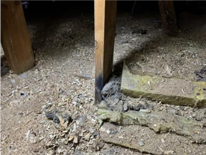
Missfärgning på träregel i vindsutrymme.
