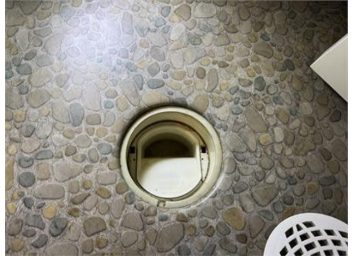
Äldre golvbrunn med förhöjningsring i tvättstuga.
