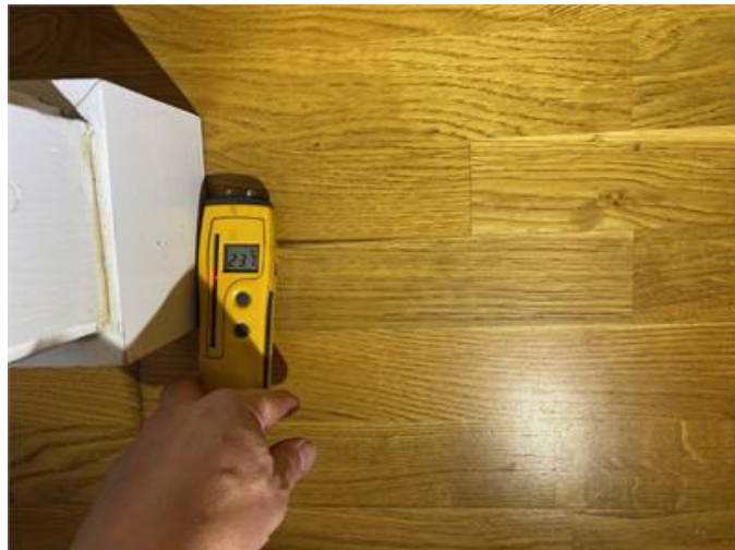
Fuktfläcka med förhöjda fuktindikationer i hall.
