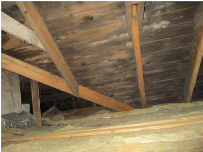
Lokala missfärgningar och mikrobiell påväxt insida yttertak i vind
