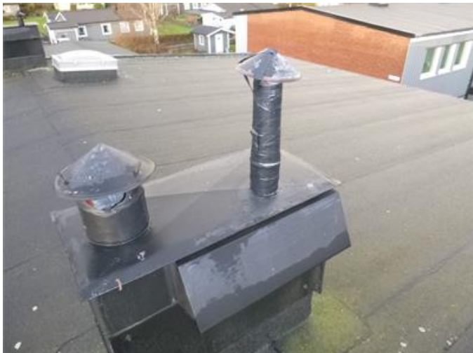
Bilden visar plåthuv där brister förekommer.
