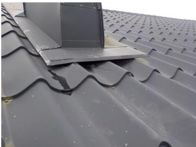
Det är öppet in mellan skorstensplåtning och takplåt.
