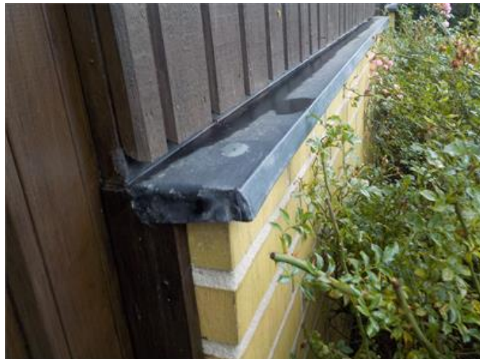
Bakfall på plåtning vid entrésidan.
