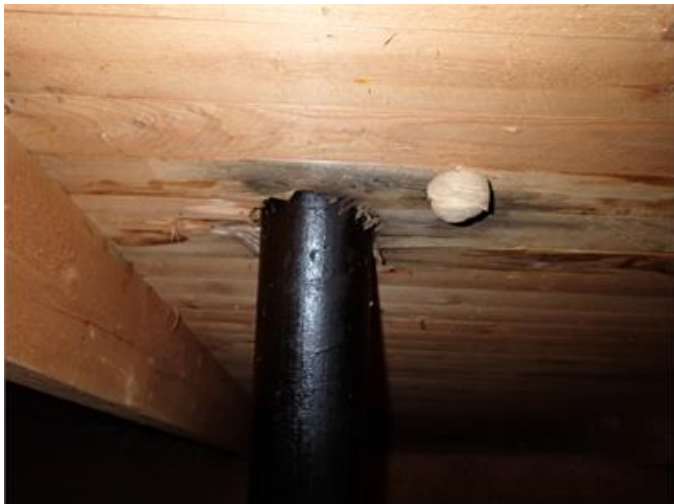
Fuktfläck vid avloppsventilation.
