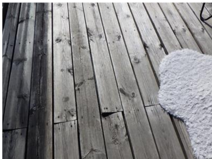
Trallgolvets infästning har delvis lossnat.
