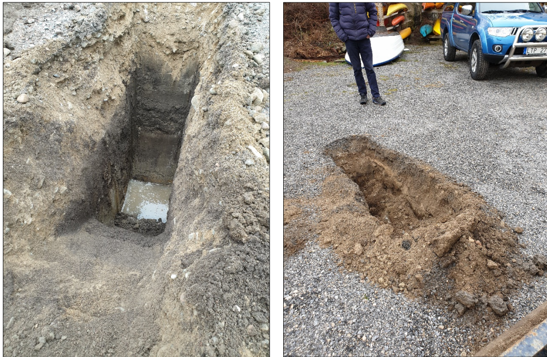
Figur 4. PG1904 till vänster där grundvatten återfanns. PG1908 med förhöjda metallhalter till höger.
