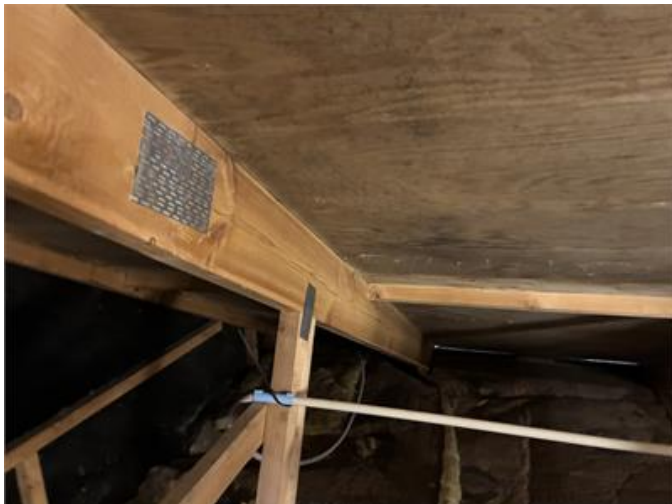
Nockvind: Missfärgningar finns på underlagstaket, torrt vid besiktningsstillfället. Se vidare "Ventilation".
