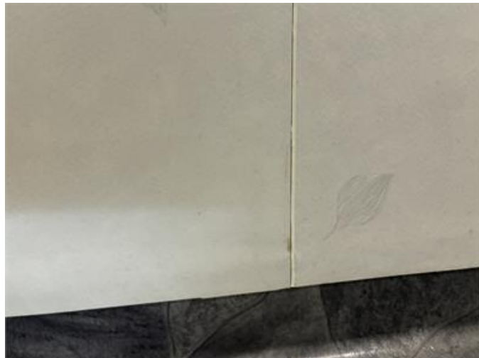
Badrum/Tvätt: Skarvar på golvet och på vägg i duschens våtzone börjar bli otäta.
