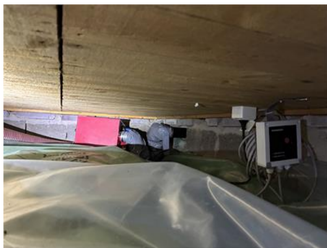
Krypgrund: Bilden visar krypgrundens adsorptionsavfuktare. Övre skiftet i grundmuren är eventuellt blåbetong.
