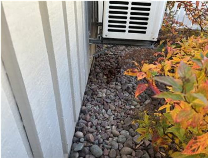
Sockel: Kondensvattnet från värmepumpens utedel samlas ej upp eller leds bort från huset. Rekommenderas som skadeförebyggande åtgärd.
