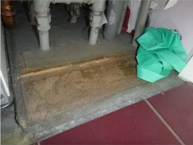
Bilden visar del av golv där tätskikt saknas.
