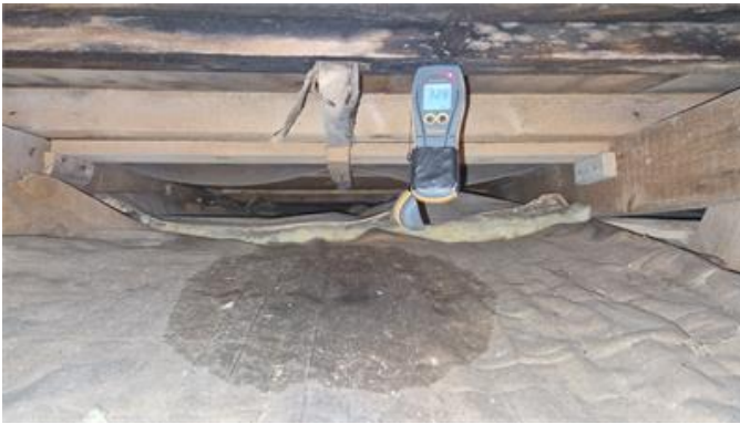
Bilden visar läckage på vinden
