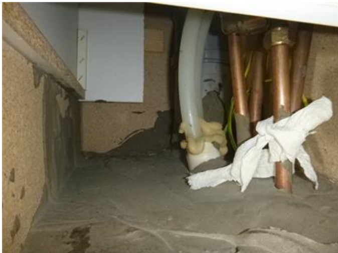
Bilden visar utrymme som ej är korrekt fuktsäkrat.
