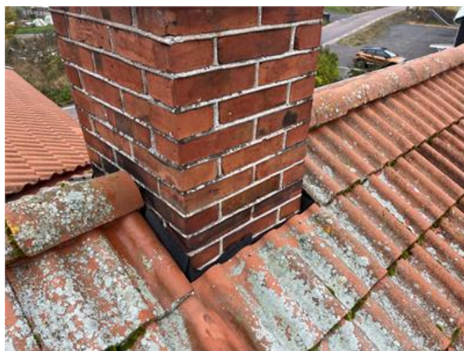
Plåtbeslag som saknas runt skorstenen.
