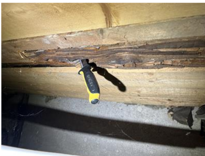
Bild från krypgrunden där lokal röta förekommer i del av träkonstruktion.
