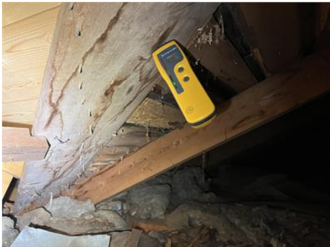
Bild från vinden, lokala fuktfläckar men inga förhöjda fuktvärden vid besiktningen.
