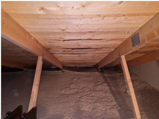
Vy på vind med fuktfläckar på underlagstak
