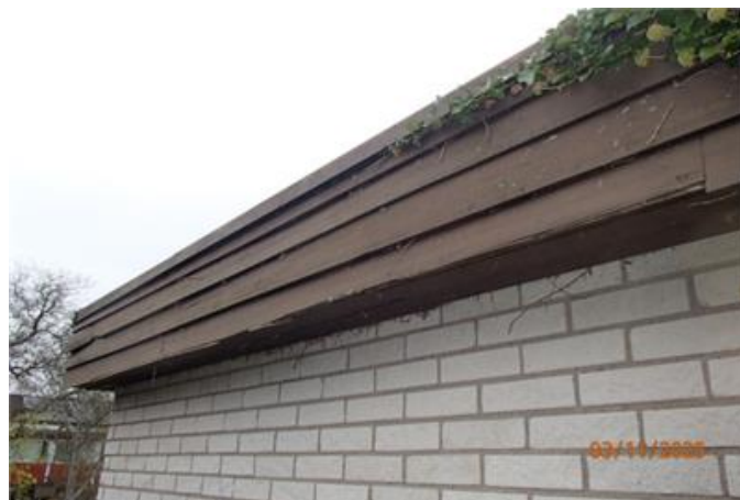
Rötskador på sargen (Garaget)
