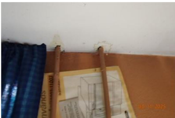
Rost noterades på rör till värmesystemet.
