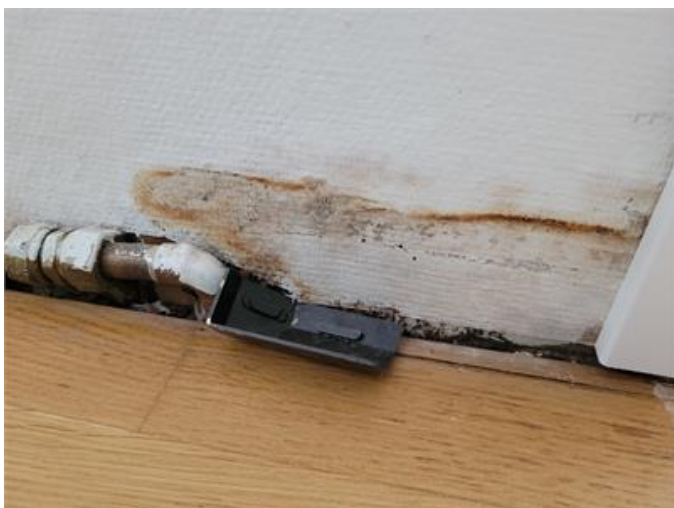
Fuktfläck invid dörr
