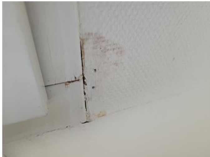
Fuktfläck invid fönster
