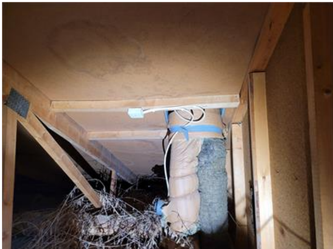
Fuktfläckar på underlagstak av board.
