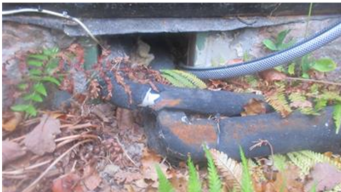
Otät rör genomföring i sockel.
